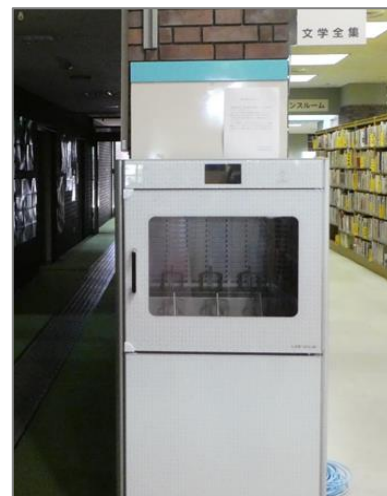
駐車場側出入口通路の手前に設置
